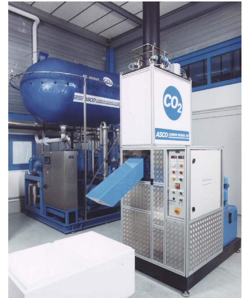
Pelletizer P600 angeschlossen an eine CO2-Rückgewinnungsanlage
